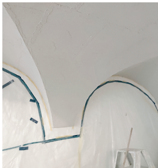
Schwierige Anschlüsse auf dem Klosterverputz.
